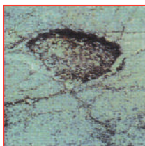
2. Les défauts du revêtement et les petites réparations pages 6 – 7
